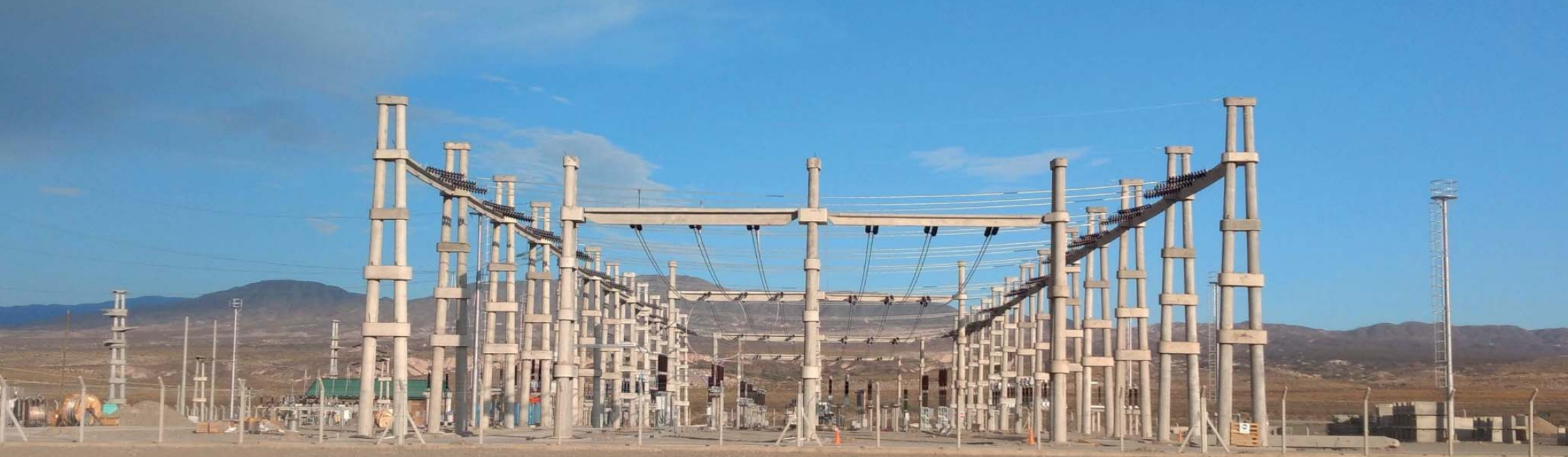
Interconexión Eléctrica 500 kV entre Estación Transformadora Nueva San Juan y Estacion Transformadora Rodeo/Iglesia
