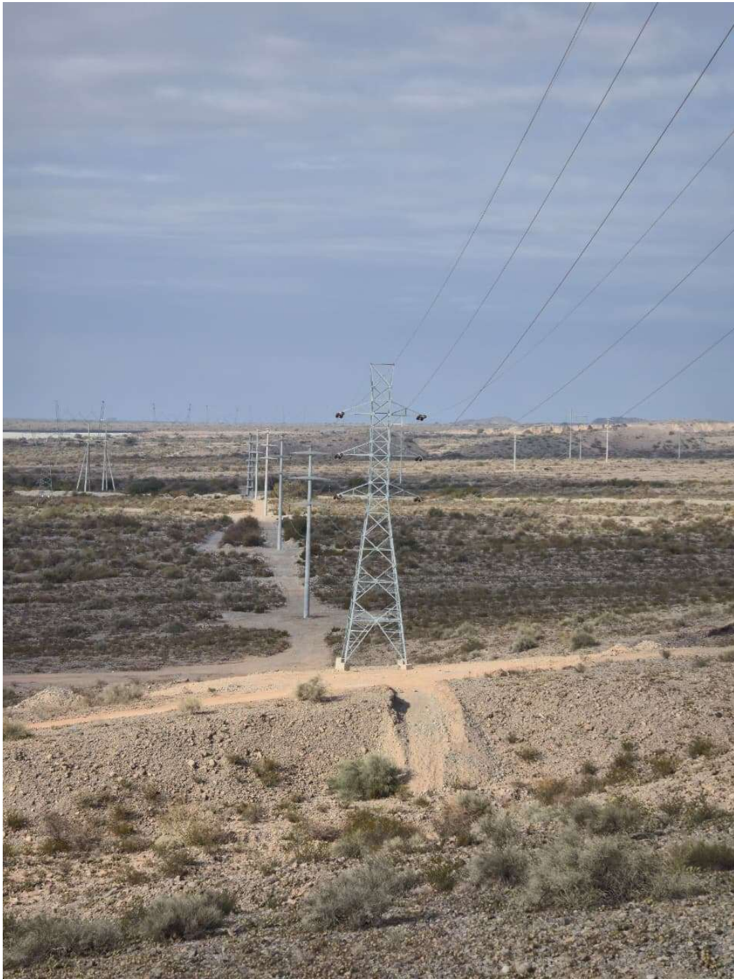
Estructuras Reticuladas - LAT 132 kV Doble Terna San Juan Sur
