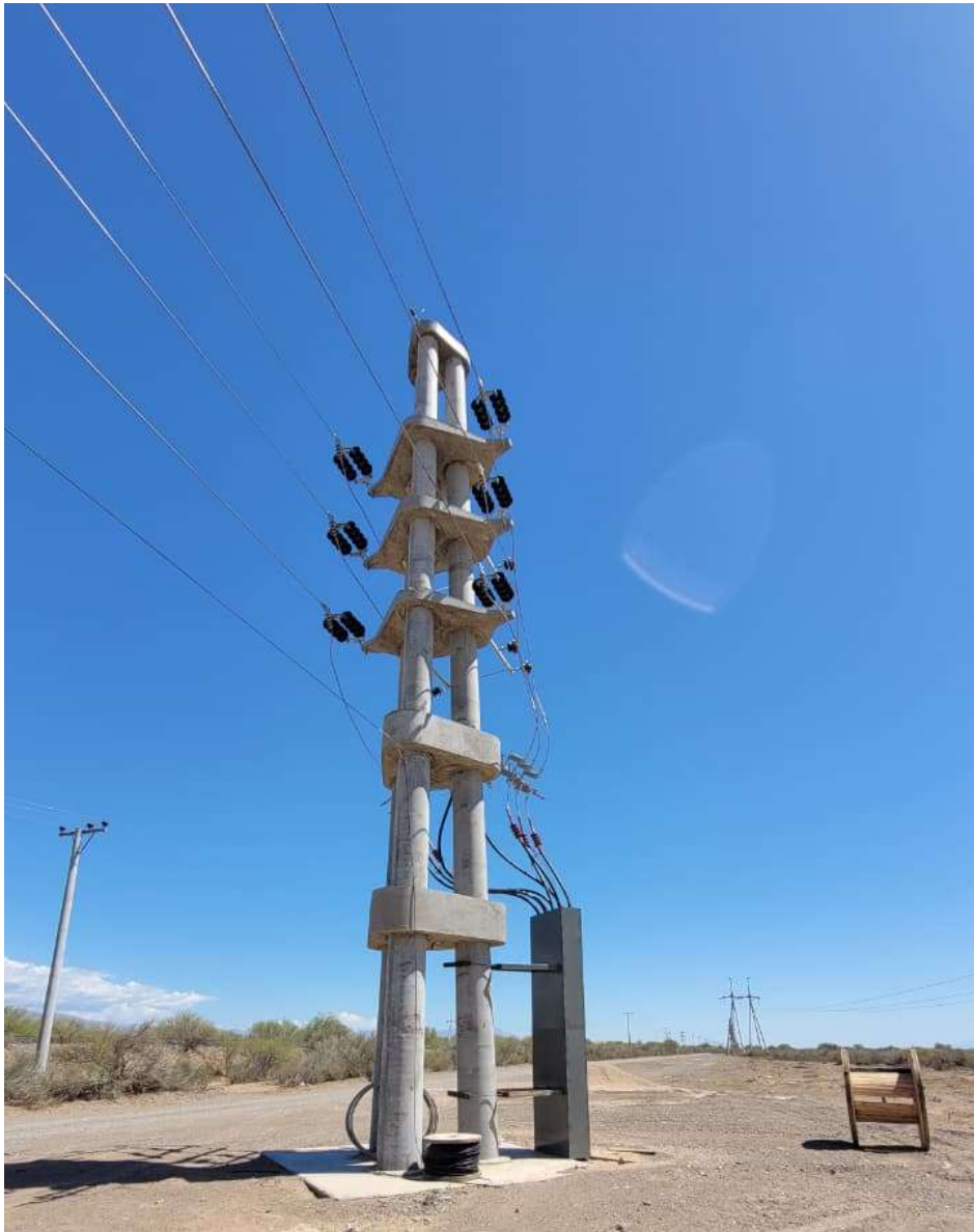
LMT 33 kV Sarmiento Sur
