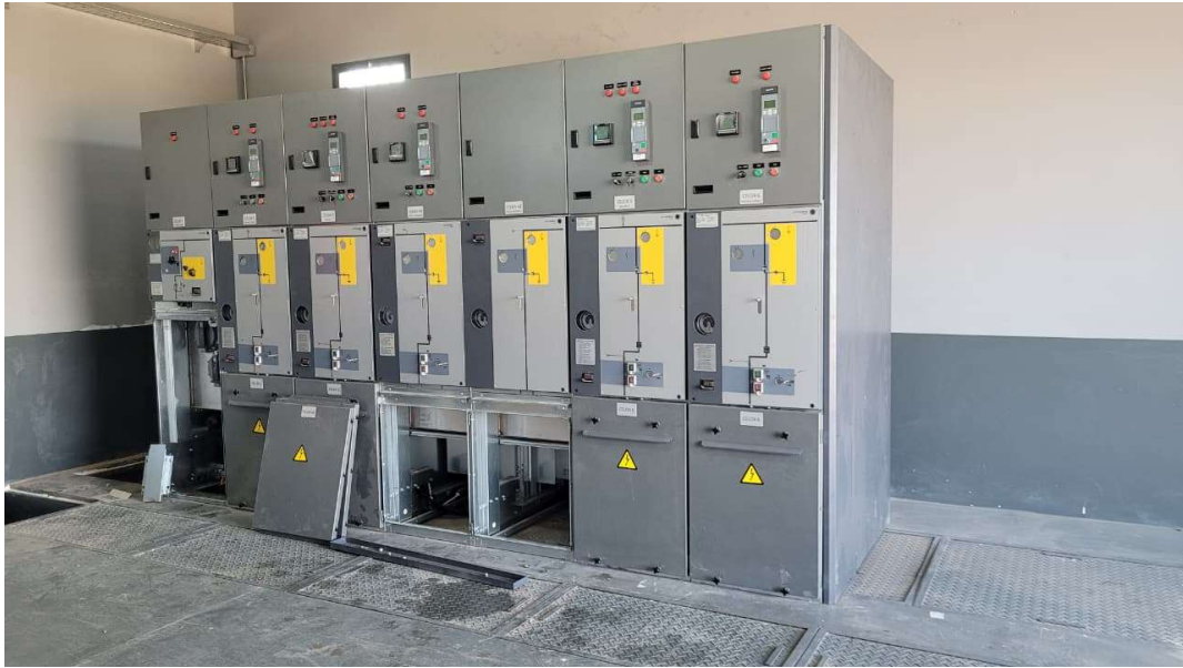
Celdas 33kV – Estación Maniobra Sarmiento Sur
