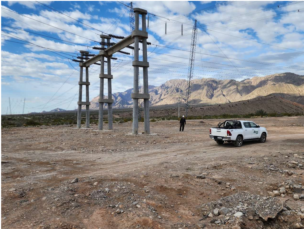
Cruce LEAT 500 kV con la nueva LAT 132 kV
