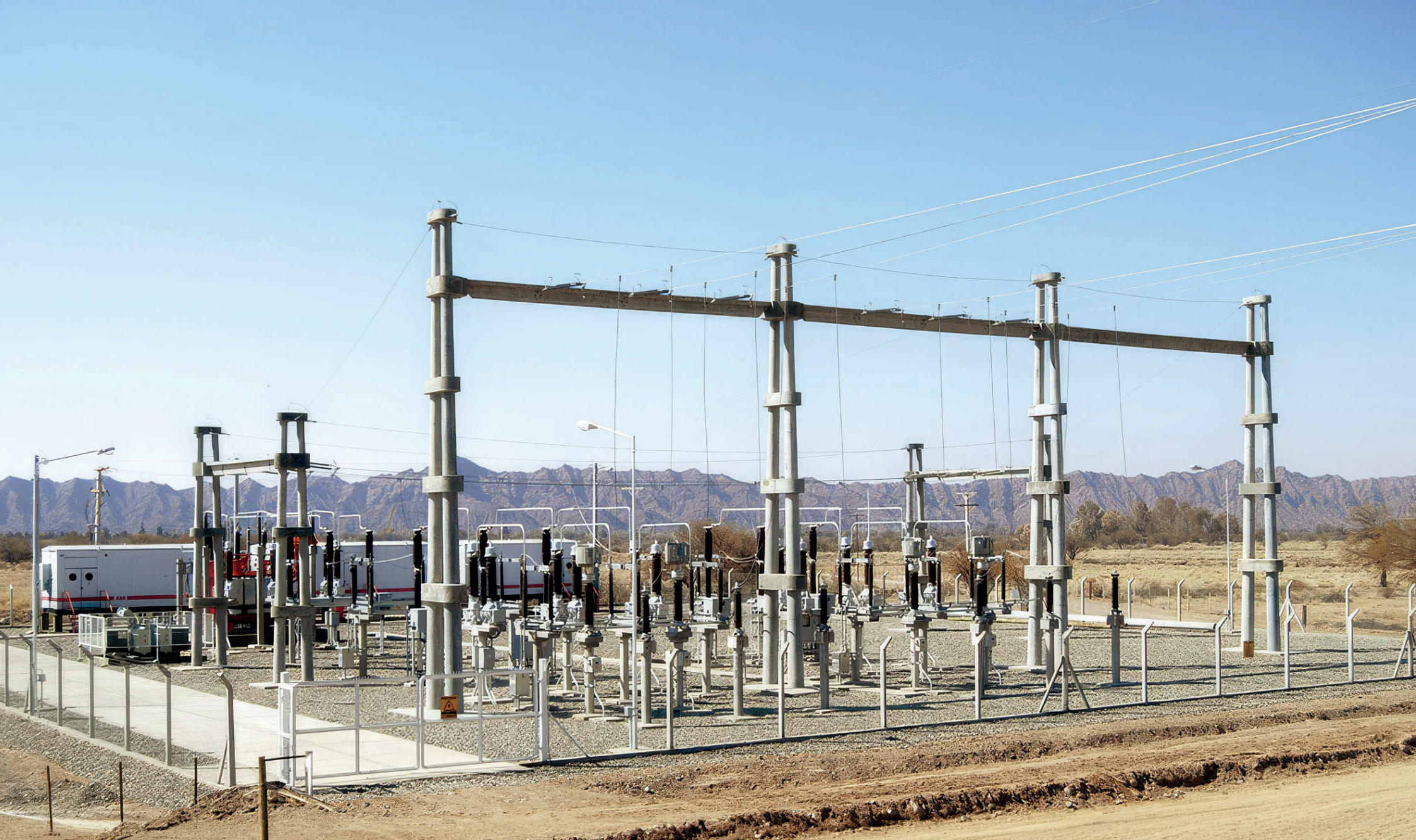
Estación Transformadora HUACO Entró en servicio en Agosto de 2010
